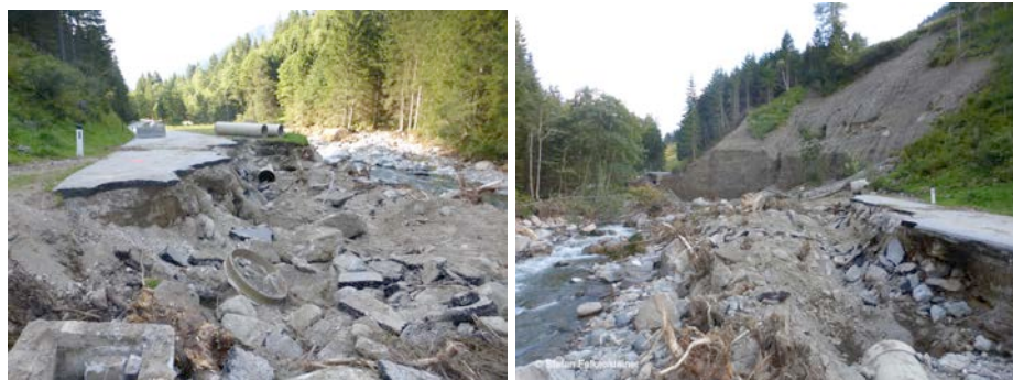
Abbildung 3: Fotos der Unwetterkatastrophe (lokale Starkniederschläge) von 4.-5.8.2017 im Großsölktal der Gemeinde Sölk bei St. Nikolai. © Stefan Falkensteiner
